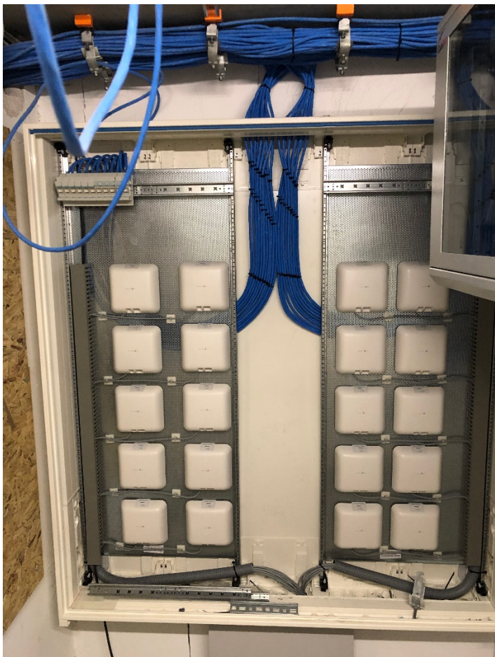
Die Abbildung zeigt den Schwachstromverteilerbereich eines Hauses in der Entstehung.
